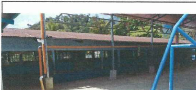
Foto 2: Se observa el derioro del techo.
