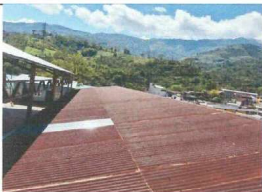
Foto 3: Se observa que las láminas ya están deterioradas y por el tipo de material provocan mucho calor en las aulas.
