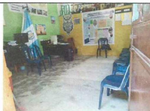
Foto 4: Se observa el piso de la Dirección del INEB deteriorado.
